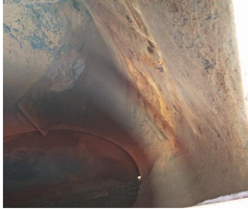
图 1 国内某输煤系统落料管内部板结挂壁现象
