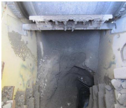
图 2 国内某输煤系统落料管内部板结挂壁现象，四方管已变成“狭窄的圆管”
