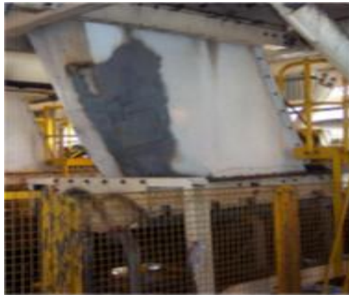
图 1 国内某转运系统落料管磨损
